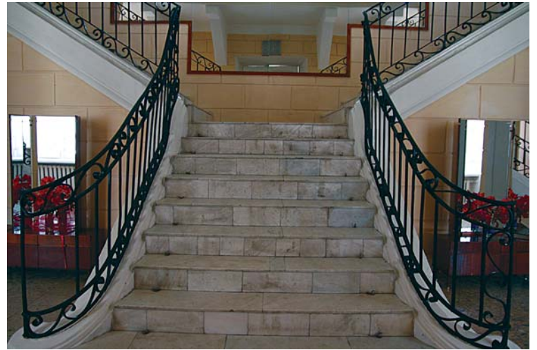
Pozostałość po dawnych wnętrzach pałacu
